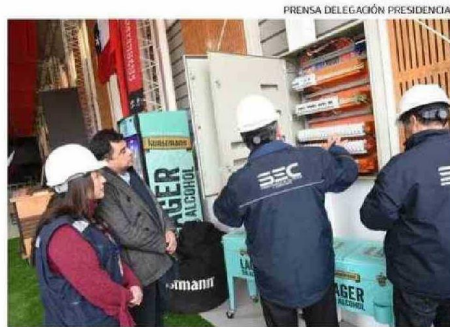
REVISARON PANELES DE INSTALACIONES ELÉCTRICAS EN LOS RECINTOS.
