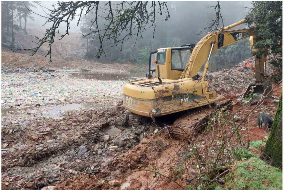
EL VERTEDERO MORROMPULLI DEBERÍA SER CERRADO EN UN PLAZO DE DOS AÑOS DESPUÉS DE LA APROBACIÓN DEL PLAN DE CUMPLIMIENTO PRESENTADO A LA SMA.
