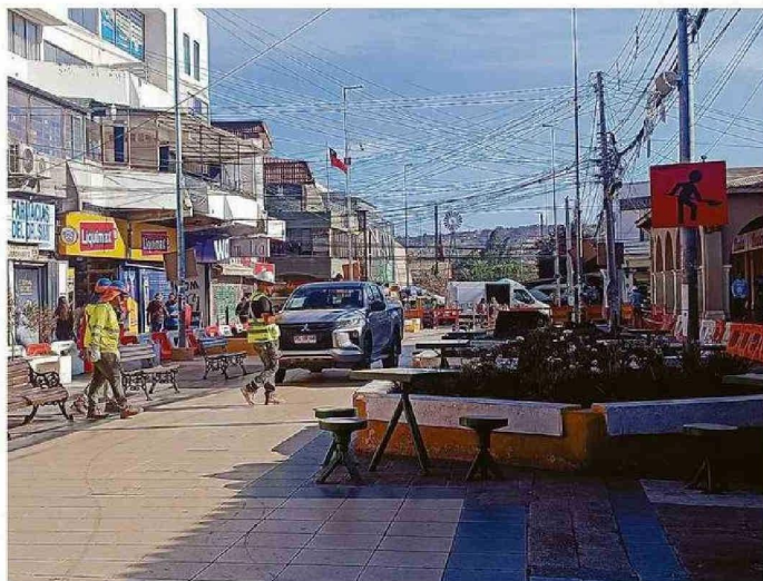
YA HAN INICIADO LAS OBRAS. SE ESTIMA QUE ESTARÁN TRABAJANDO 350 DÍAS EN PASEO LATORRE
