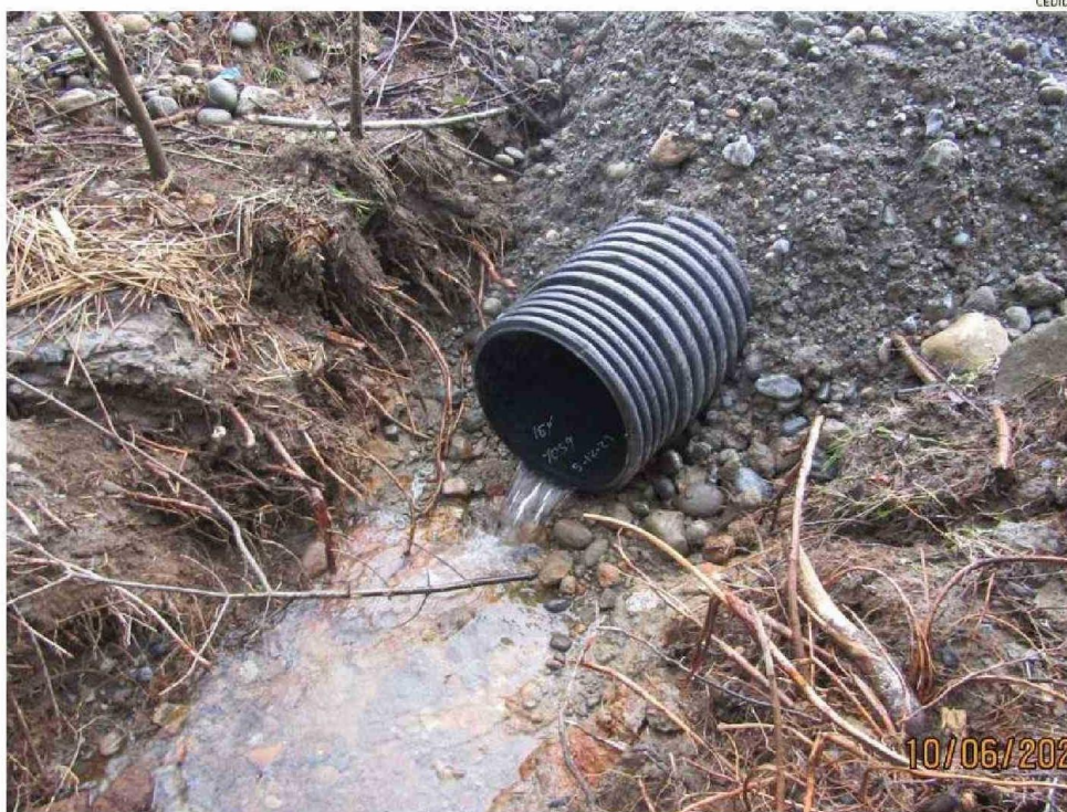
ESTE ES UNO DE LOS TUBOS DENUNCIADOS POR LA FUNDACIÓN GAYI QUE FUE INSTALADO PARA DESVIAR LAS AGUAS DE UNO DE LOS HUMEDALES.
