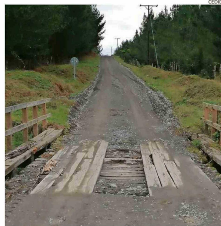
MUCHOS CAMINOS TIENEN PUENTES DE MADERA EN MAL ESTADO.
