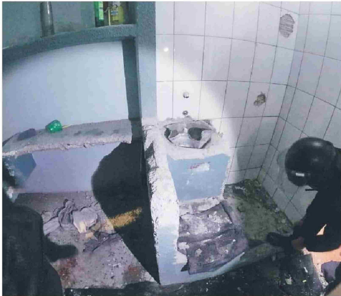
► Internos destrozaron baños, cañerías de agua y ductos, baldosas, entre otros elementos.
