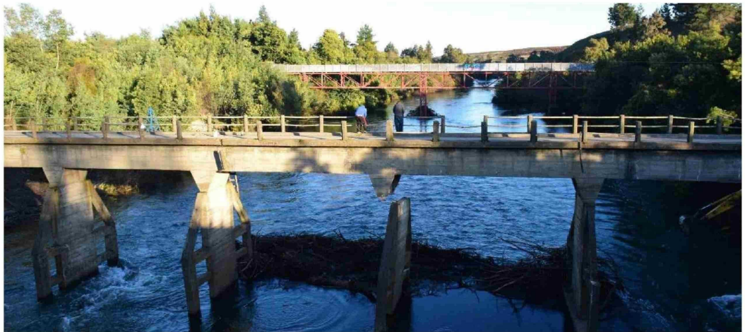
EL COLAPSO DE UNA DE LAS PILASTRAS centrales de la balsa pone en riesgo la producción agrícola y ganadera de una zona que depende de este sistema de riego.
