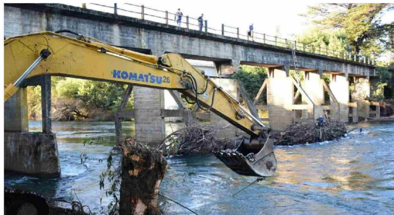
TRAS LAS CRECIDAS Y DESBORDES, PROVOCADOS en medio del sistema frontal de junio pasado, actualmente se trabaja con apoyo de maquinaria pesada en la limpieza y el despeje de la zona.
