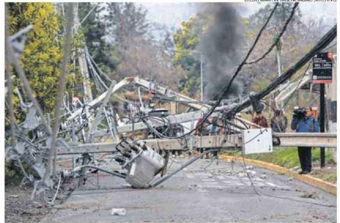
INFRAESTRUCTURA ELÉCTRICA FUE DAÑADA POR VIENTOS DE MÁS DE 120 KM/H EN LA CAPITAL, A INICIOS DE MES.
