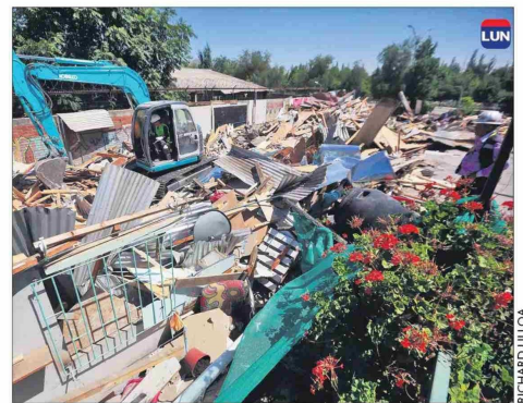
La toma destruida.
