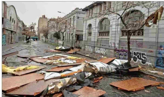
TECHOS. — El viento dañó la infraestructura de casas y establecimientos en múltiples regiones, como fue en el caso del Liceo de Aplicación.
