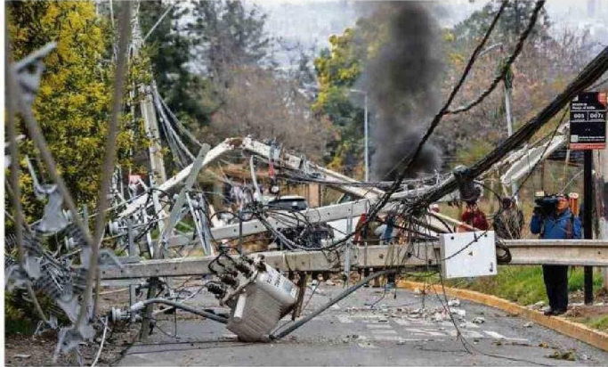
INFRAESTRUCTURA ELÉCTRICA FUE DAÑADA POR VIENTOS DE MÁS DE 120 KM/H EN LA CAPITAL, A INICIOS DE MES.
