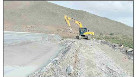
El escurrimiento de relaves sobrepasó las piscinas de emergencia del proyecto.
