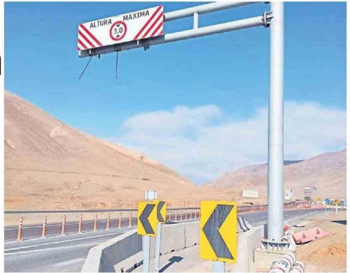
LAS BARRERAS FUERON DAÑADAS POR UN CHOQUE DE UN BUS INTERURBANO.
