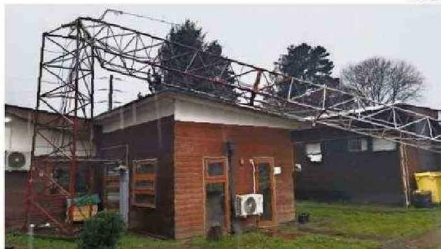
UNA TORRE DE COMUNICACIONES DE CONAF SE CAYÓ, EN TEMUCO.
