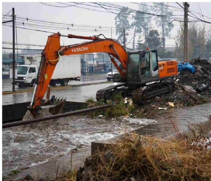
► Equipos de emergencia trabajaron para evitar el desborde del Canal Santa Marta.
