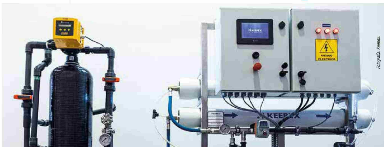
Sistema desalinización por ósmosis | Keepex.
