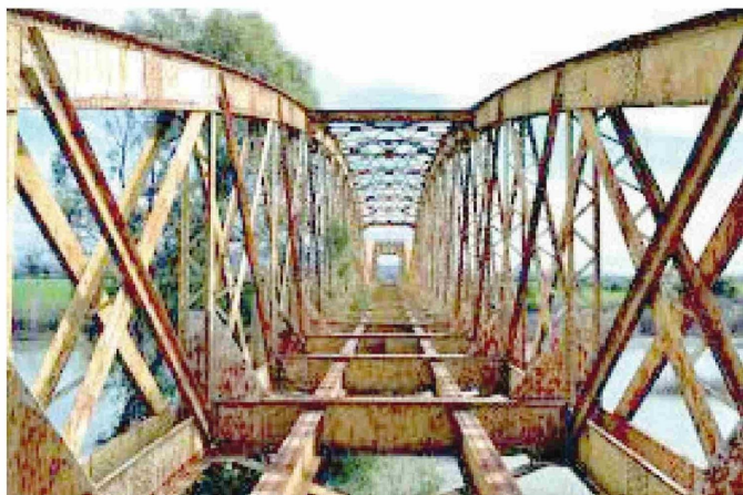
Puente ferroviario del ramal Parral-Cauquenes, de 1896, Monumento Histórico desde el 2000. Muy deteriorado y sin señalización.
