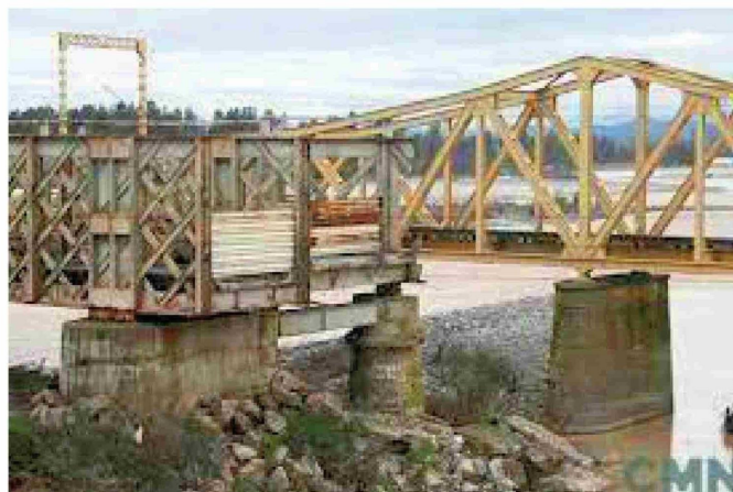
Puente ferroviario y carretero del Maule, data de 1890, monumento desde 1993, se derrumba lastimosamente ante el abandono de las autoridades.
