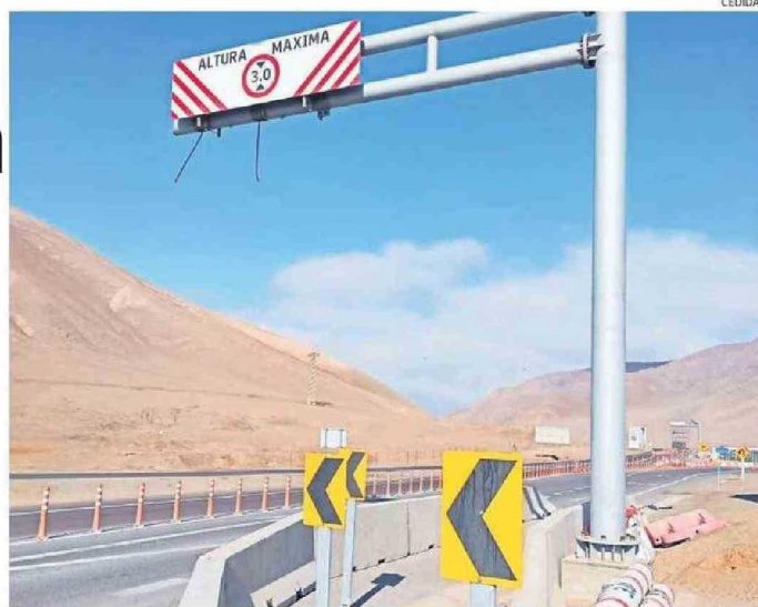
LAS BARRERAS FUERON DAÑADAS POR UN CHOQUE DE UN BUS INTERURBANO.
