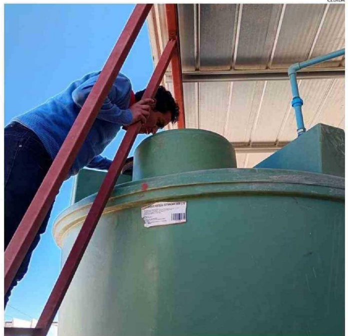
ESTE HOTEL TIENE UN MODERNO SISTEMA DE ELECTROCOAGULACIÓN, TRATAMIENTO DE AGUAS.
