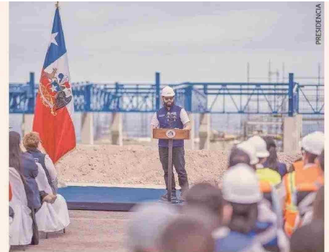
El Presidente visita las obras de construcción de una planta desaladora de agua de mar en Tocopilla para Codelco.
