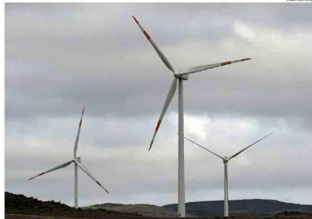
LOS PARQUES EÓLICOS SE HAN MULTIPLICADO EN CHILE EN LAS ÚLTIMAS DÉCADAS.
