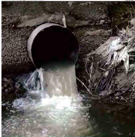
EN FEBRERO SE DETECTÓ UN DUCTO CON AGUAS SERVIDAS EN EL RÍO, PERO LA SISS NO PUDO ESTABLECER EL ORIGEN DEL LÍQUIDO PUTREFACTO.
