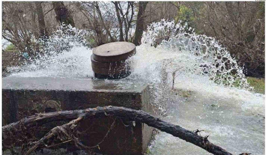
DURANTE AGOSTO, DOS DESCARGAS DE AGUAS SERVIDAS SE DERRAMARON POR EL RÍO RAHUE DESDE UNA CÁMARA DE LA FIRMA SANITARIA SURALIS.
