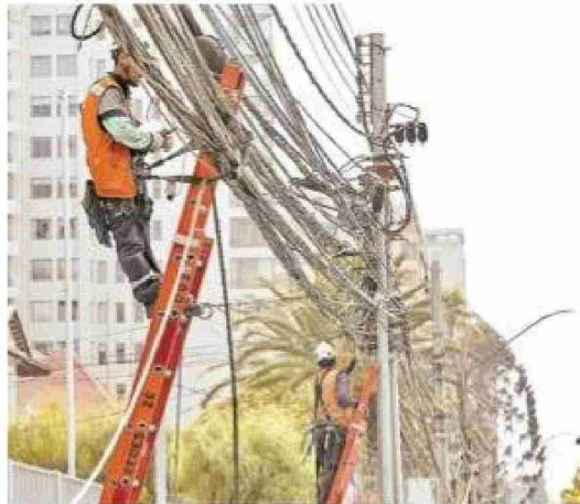
El masivo corte de energía que afectó a Chile ayer, dejó a millones de personas sin suministro eléctrico.
