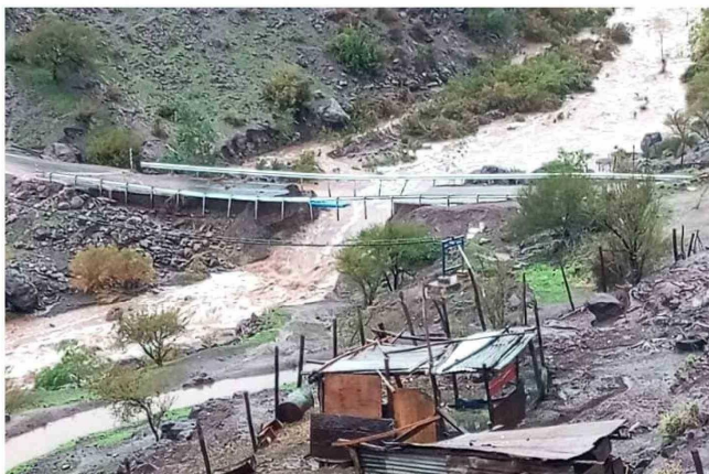
En la Ruta D-783, que conecta el Valle Hermoso con Matancilla, en Combarbalá, el tránsito se encuentra suspendido por la destrucción del puente sobre río Pama.
