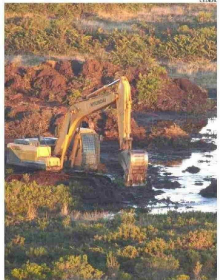
EN PUERTO MONTT Y OSORNO SE HA FRENADO EL DAÑO A HUMEDALES.
