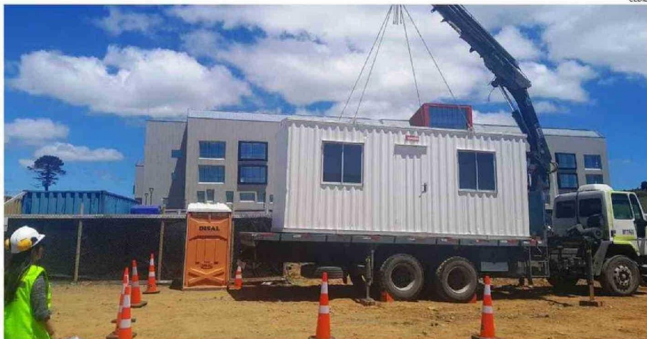
LAS ACTUALES LABORES DE SURALIS INCLUYEN LA CONSTRUCCIÓN DE ZANJAS UTILIZANDO MAQUINARIA PESADA.
