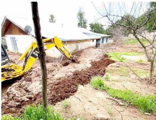
La Posta de Upeo fue una de las más afectadas con las inundaciones del año pasado.
