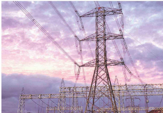
Instalaciones de ISA InterChile en la Línea de Transmisión Cardones-Polpaico. / ISA INTERCHILE
