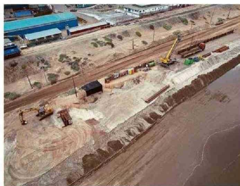
DESALINIZADORA DE AGUAS PACÍFICO EN QUINTERO-PUCHUNCAVÍ.
