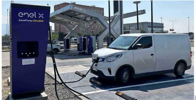
Electroestación Enea, de Enel X, en Pudahuel.
