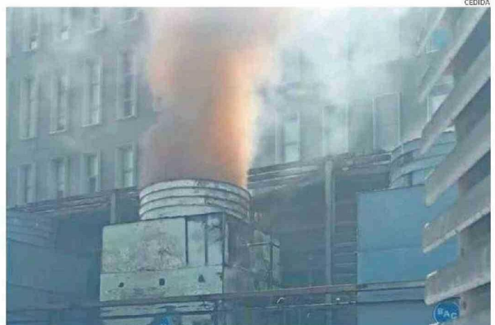
EL SINIESTRO SE GENERÓ EN EL CUARTO PISO EN EL SECTOR DEL EDIFICIO DE LA UNIDAD DE PACIENTE CRÍTICO.
