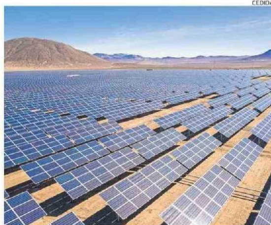
EL PARQUE SOLAR ESTARÁ UBICADO A 122 KM AL ESTE DE ANTOFAGASTA.
