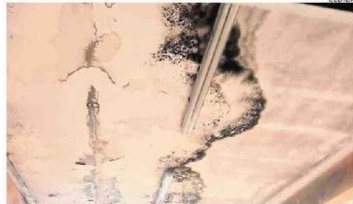
RECLAMARON POR MALAS CONDICIONES DE LAS AULAS.
