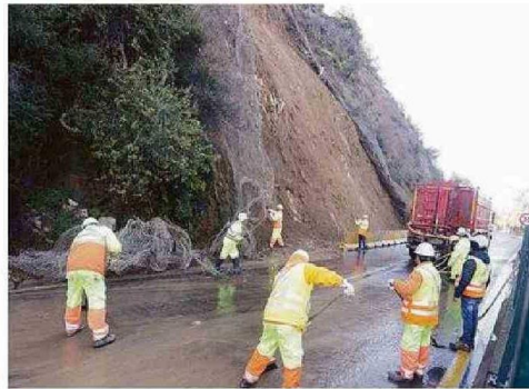
DERRUMBE SE PRODUJO EN EL KILÓMETRO 108 DE LA AV. SANTOS OSSA.
