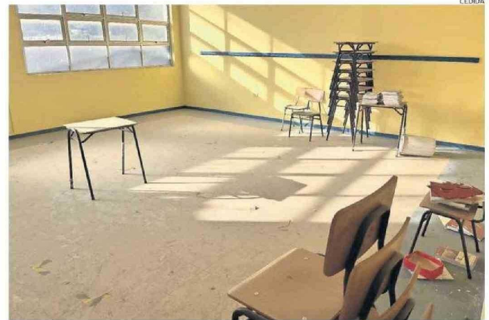
DEMOLICIÓN ES DEBIDO A LOS IMPORTANTES DAÑOS ESTRUCTURALES QUE PRESENTA EL ESTABLECIMIENTO.
