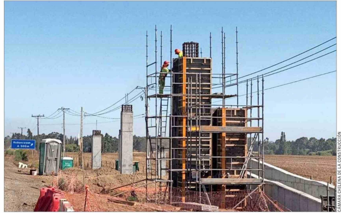
PROTECCIÓN EN LA EJECUCIÓN DE DIVERSOS PROYECTOS. — La Cámara Chilena de la Construcción lanza campaña para impulsar obras en regiones de la macrozona sur.
