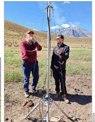
Para el monitoreo de aguas subterráneas se instalaron antenas de transmisión satelital como esta.
