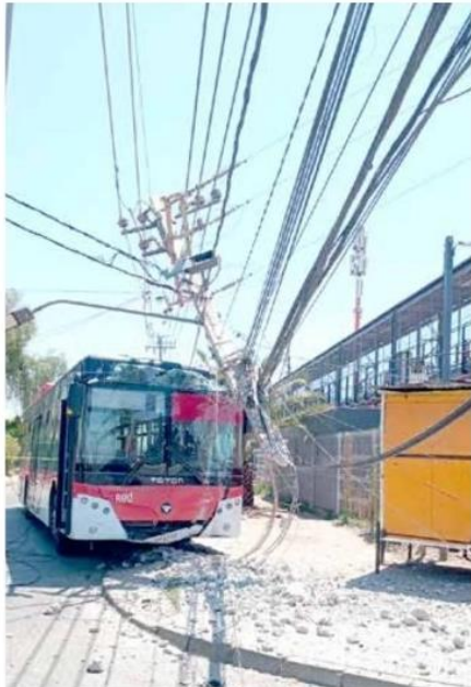
Hay vecinos de la Región del Maule que han debido soportar hasta 12 horas sin luz para la reparación de un poste chocado.
