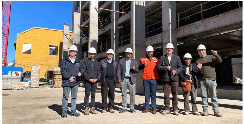
En la imagen, la delegación de consejeros regionales, acompañados por el alcalde de Ovalle, Jonathan Acuña, recorre las obras del futuro edificio consistorial de Ovalle.
