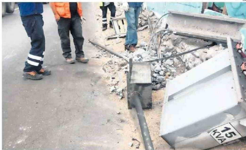
NO SOLO LOS ROBOS: LOS CHOQUES DE POSTES AFECTAN LOS SISTEMAS DE ILUMINACIÓN.
