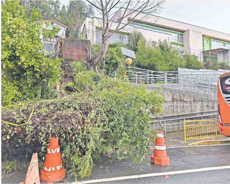
Una escuela de la comuna de Arauco presenta mucho riesgo por remoción de tierra.
