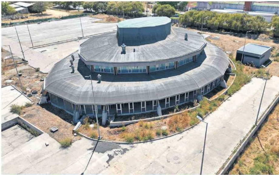
Las obras del mercado de Arauco hoy se encuentran abandonadas tras la salida de la constructora Andes en 2023.
