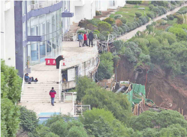
Gigante es el nuevo socavón aparecido en zona de dunas de Viña del Mar. / AGENCIAUNO
