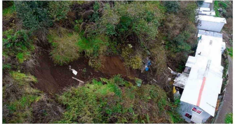
EL SOCAVÓN EN LA LADERA DEL CERRO MAC IVER DE POBLACIÓN MODELO EN PUERTO MONTT ES EVIDENTE.
