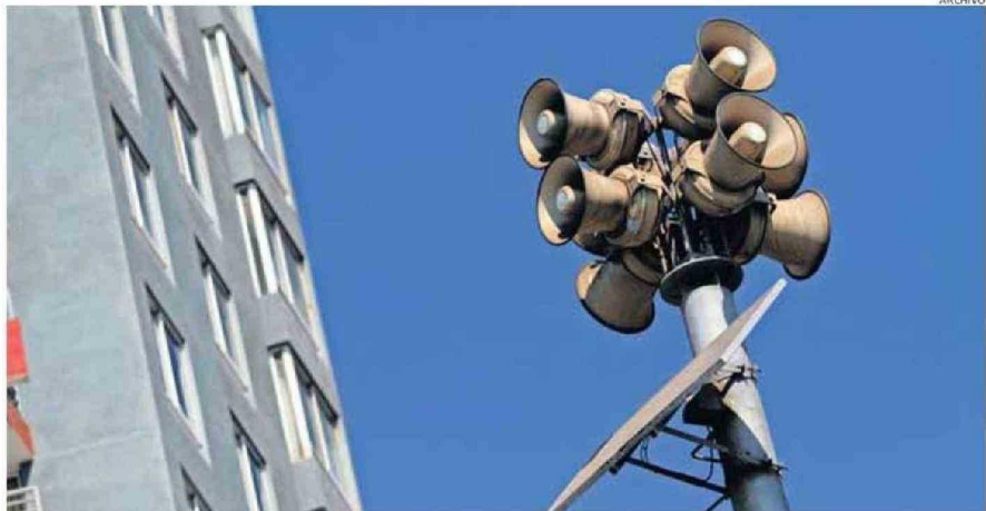
ESTE NUEVO SISTEMA CONTEMPLA POSTES DE ACERO DE 11 METROS DE ALTURA.
