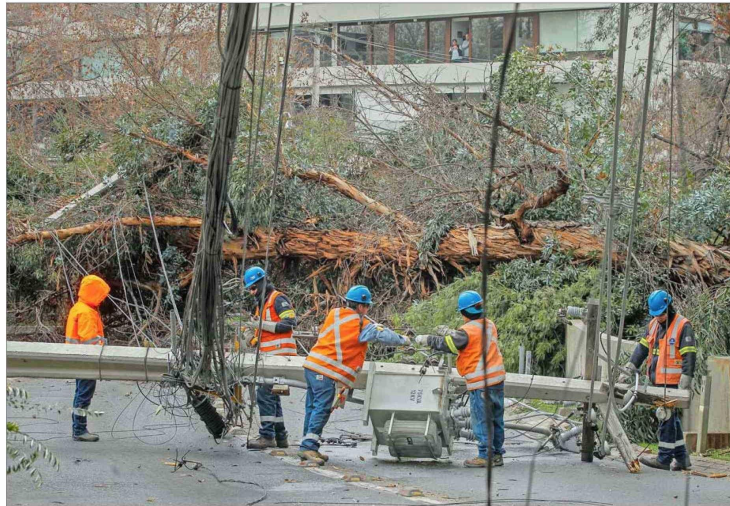
Árboles y ramas caídas son, por lejos, la principal causa del corte del suministro eléctrico. De ahí que la mantención preventiva con tecnología de punta surja como una solución prioritaria.
