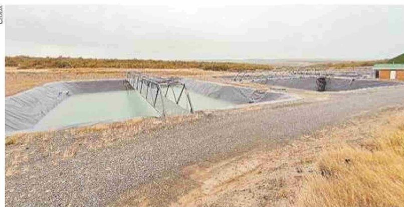
A más de tres años de terminadas las obras, aún no se puede utilizar el relleno sanitario.
