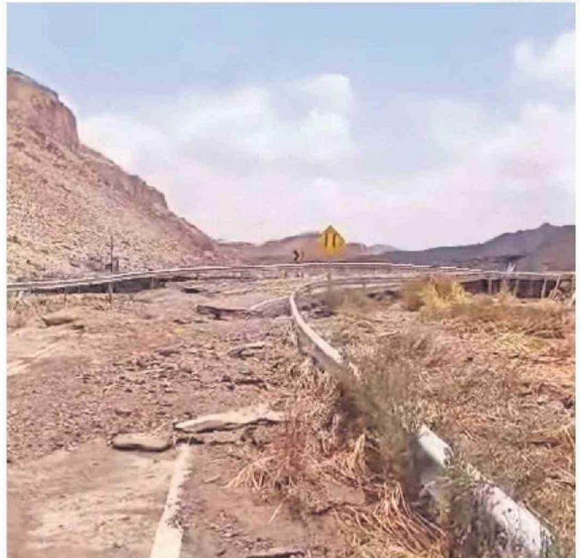
VECINOS DEL SECTOR ALERTARON SOBRE LOS DAÑOS EN EL PUENTE DEL VADO SANTA BÁRBARA.
