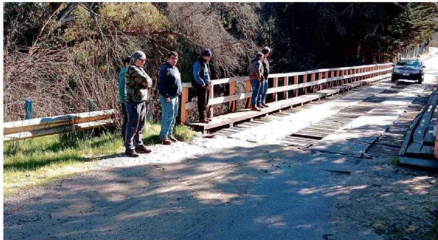
EL MUNICIPIO RECOMENDÓ NO TRANSITAR CON VEHÍCULOS LIVIANOS Y PESADOS POR EL PUENTE.
