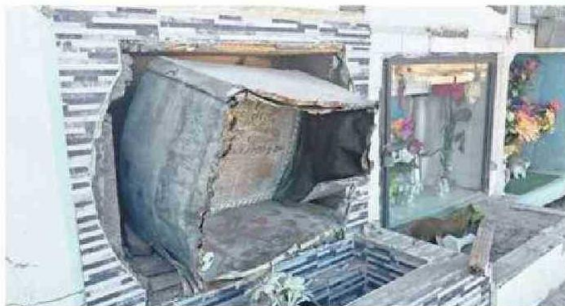
AÚN NO SE HA DETERMINADO LA CANTIDAD DE NICHOS AFECTADOS.
